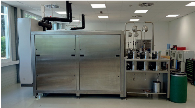
Abb. 1: Außenansicht der Hochdruck Extraktionsanlage (eigenes Foto)
